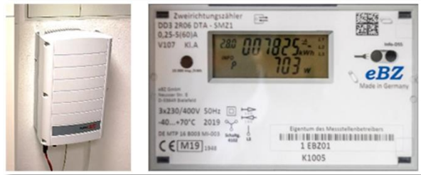
Wechselrichter und Zweirichtungszähler
