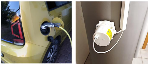
E-Fahrzeug-Ladung und Brauchwassererwärmung
