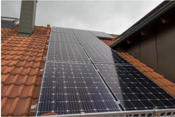
Hausdach mit Solar-Modulen zur Stromerzeugung
